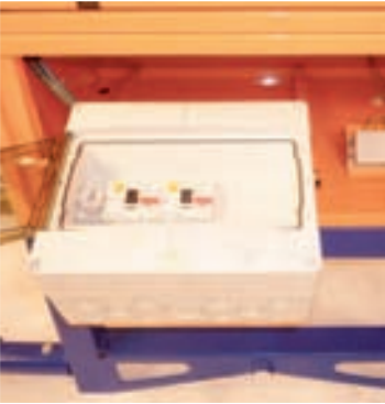
Technik-Schließfach mit Sicherungskasten
