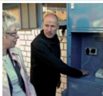
▲ Je Fach 2 Steckdosen, mit FI-Schalter abgesichert
